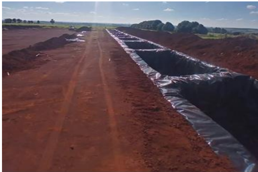
Imagem 06 - Utilização de Manta Geomembrana nas valas do aterro sanitário, a fim de evitar contaminação do solo. Fonte: SEMMA.
