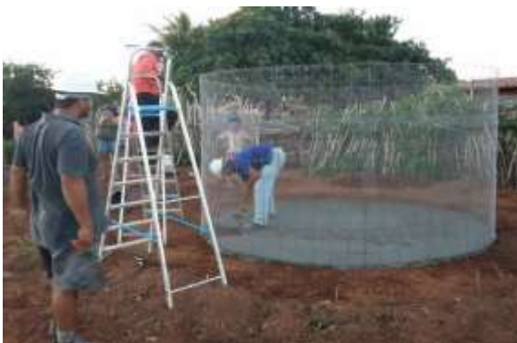
Figura 13 - Construção de cisterna na comunidade de Brinco de Ouro. Foto: SEBRAE RN.
