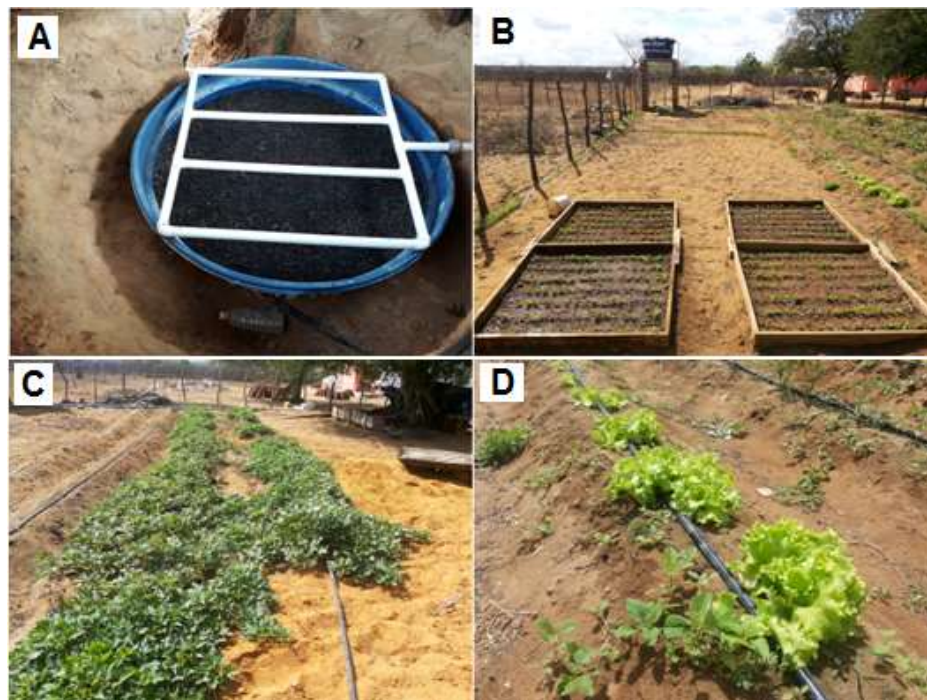
Figura 18 - Filtro principal do sistema de reuso de águas cinzas (A) e produção de hortaliças (B, C e D) sendo irrigadas com a água de reuso em residência rural, na comunidade de Baixa do Novilho, no município de João Câmara. Foto: SEBRAE RN.
